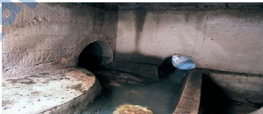
Figure I.11 : Un déversoir d'orage [15]
