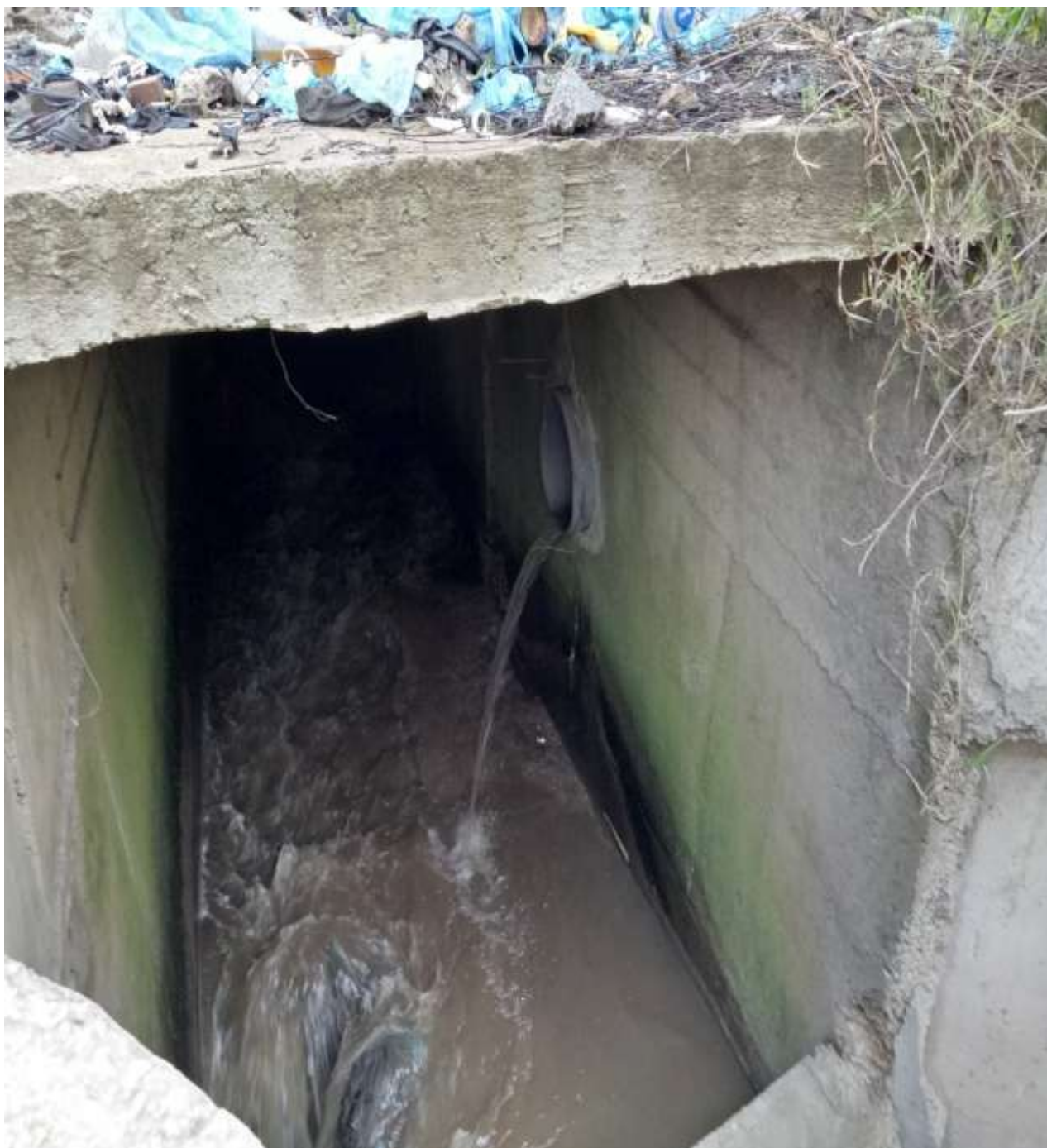
Figure III.5 : Déversoir d'orage (Feddan Sbaa)
