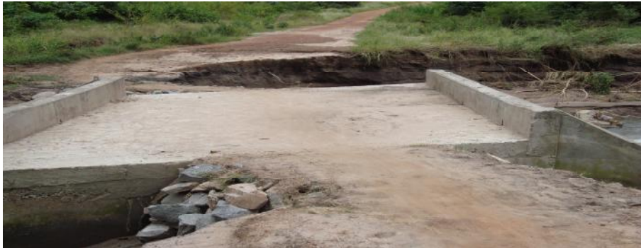
Photo 4: destruction de voie de desserte à Houin (Glazoué)
