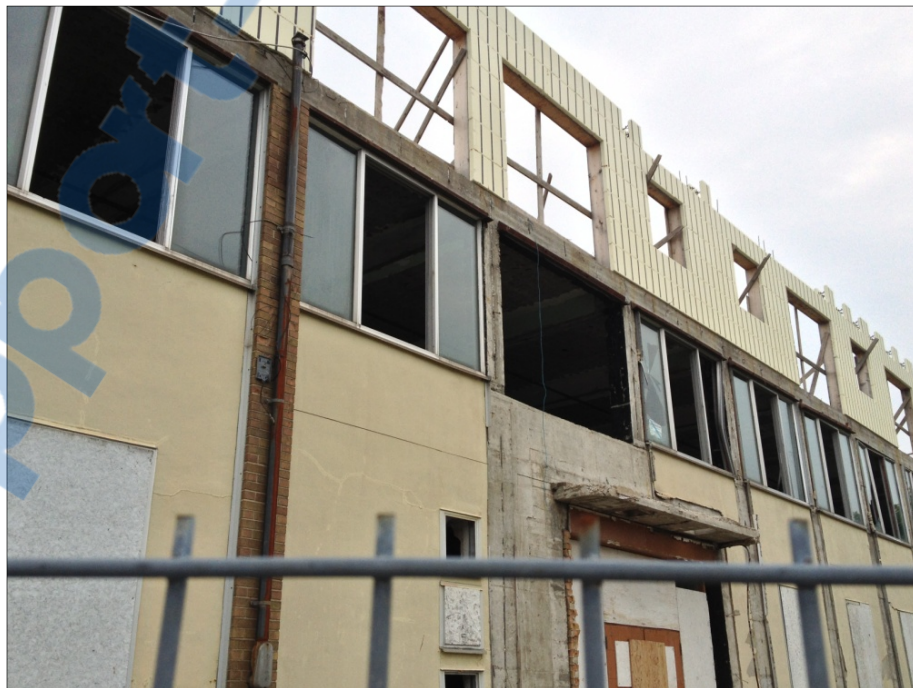
Figure 2.13 Ouvertures nombreuses et absence de remplissage de la même école sur le coté longitudinal
