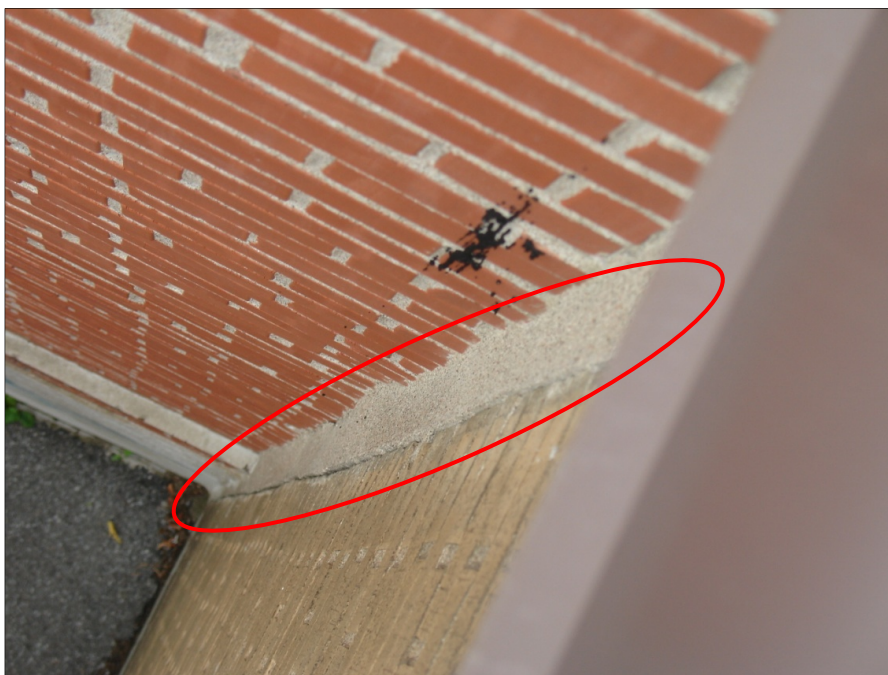
Figure 2.18 Joint de séparation mal conçu d'école primaire (Montréal) entre deux blocs de différentes couleurs de briques
