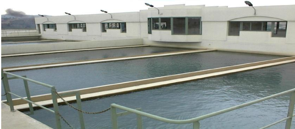
Figure 5 : Filtre à sable
