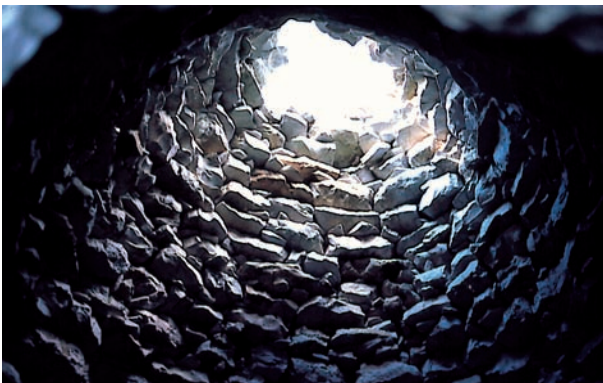
Fig. 22 - Borie aux Claps (Alpes-Maritimes). Voûte partiellement effondrée en raison des lits irréguliers et des pierres mal bloquées entre elles.
