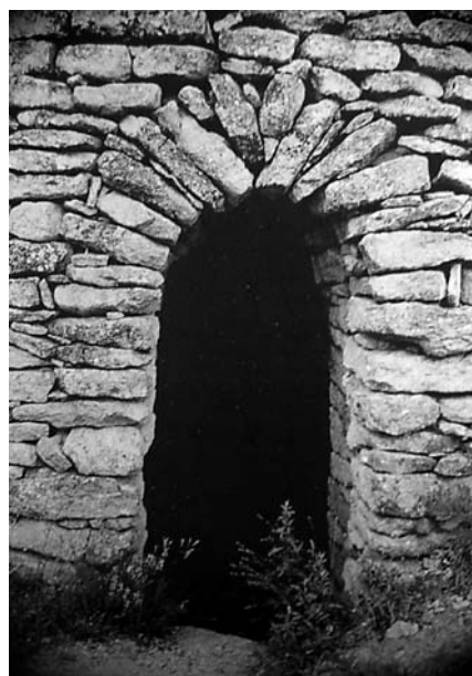
Fig. 39 - Voûte d'entrée de borie mal exécutée. Le blocage de la clef de voûte est mal réalisé.
