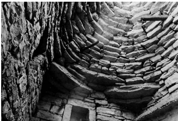
Fig. 37 - Trullo en Italie du Sud. Construction sur plan carré. Les dalles d'angle qui supportent la calotte conique sont fissurées ; la sécurité n'est plus assurée.
