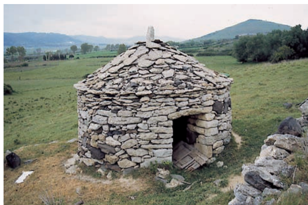
Fig. 28 - Pinnetta de Sardaigne. Construction soignée en cours de dégradation.
