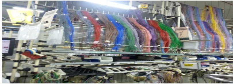
Figure 27 : L'état de la cellule 6
