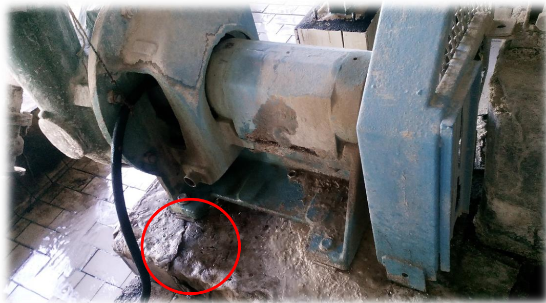
Figure 17 : Dégradation des fondations
