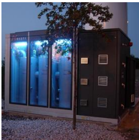
Limiteurs de courant de défaut supraconducteurs de Nexans en Allemagne
