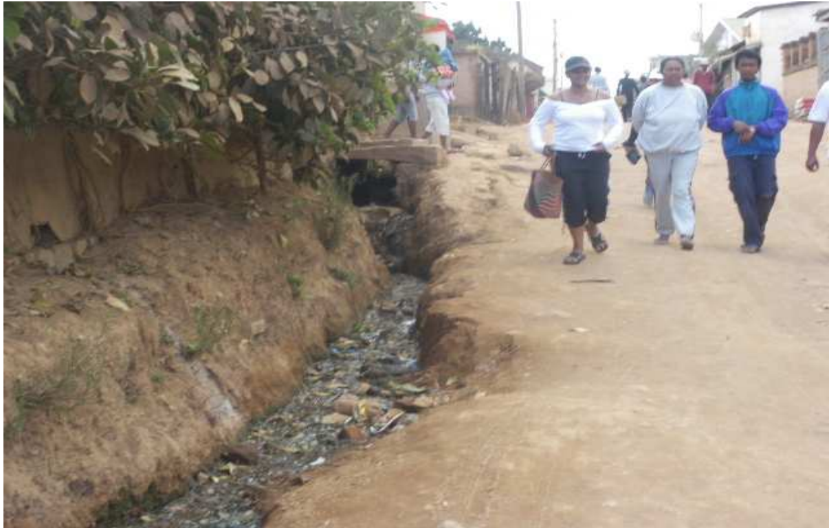
Photo 11 : Photos prise lors de notre enquête entre Ampitatafika –Itaosy illustrant l'état dégradé de la route et la pollution induite faute de canaux d'évacuation (on en trouve tout au long du tracé)
