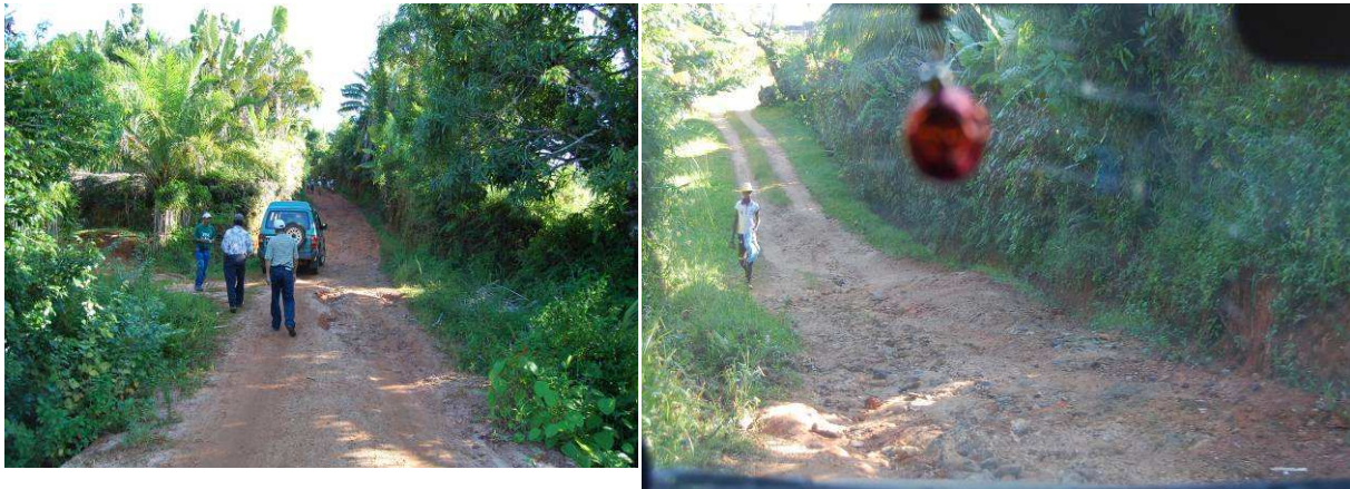
Figure 2: Cloutage et Macadam lessivés (PK 32+300 et PK 32+850)
