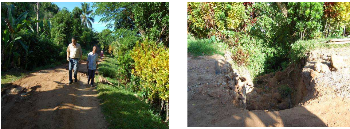
Figure 3 : Effondrement d'une buse au PK 32+600
