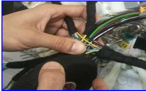
Figure 4.13 : Etat avant amélioration des fixations des fils
