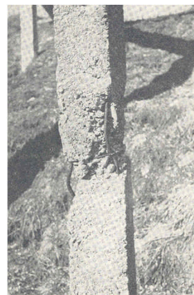
Rupture en compression d'un poteau survenue à un endroit faible (nid de cailloux)
