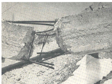
Rupture en traction (flexion) d'une poutre survenue à un endroit faible (mauvais recouvrement de armatures)
