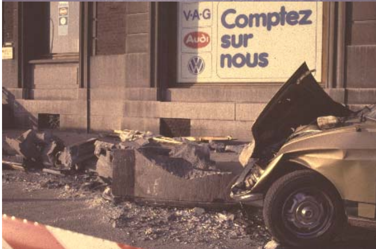
Figure 5.32. Chute de garniture en pierre. En haut, centre ville ; en bas Quai de Rome (Liège, 1983).
