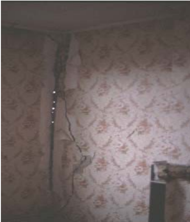
Figure 5.17. Liège, 1983. Effet de la faiblesse des diaphragmes (fissuration à l'angle des murs) ou de la faiblesse de leur connections aux murs (effondrement de façade).
