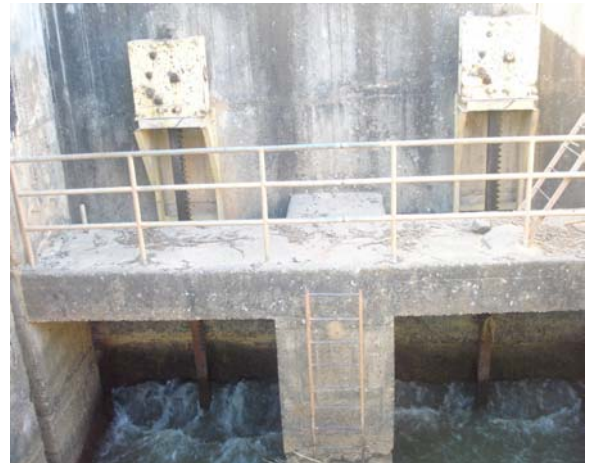
Photo n°6 : Les pertuis munis de vannes
