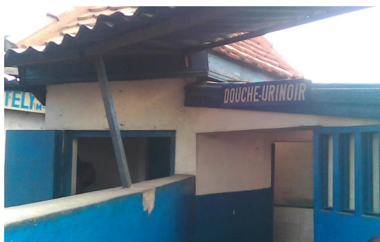
Photo n°11 : urinoir installé dans espace exigu
