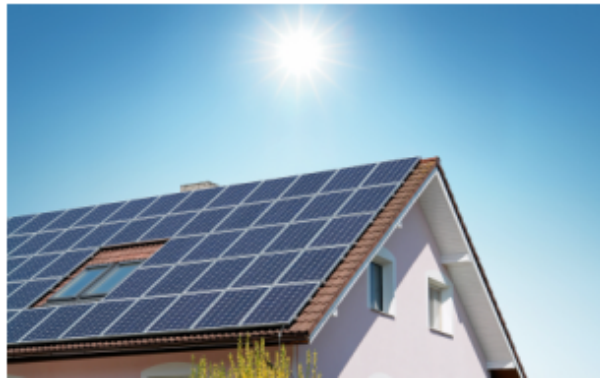
FIGURE 1.1 – Panneau solaire sur toit
