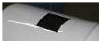
47. 48. Découpe d'un carré avec une scie circulaire sur le couvercle et sur le bidon.
