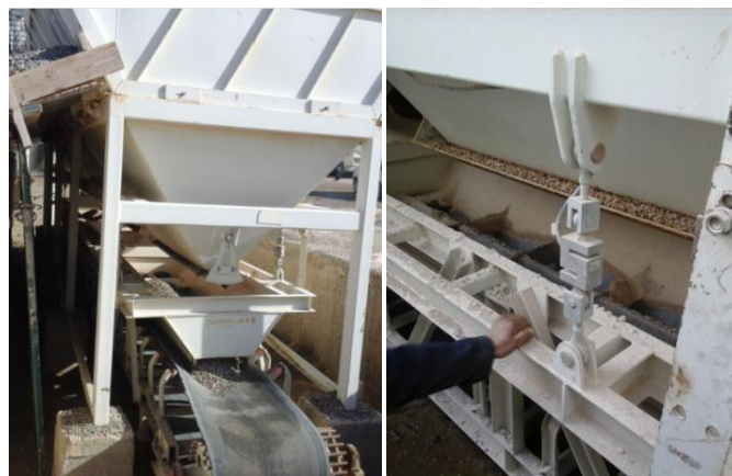
Figure 2. 10 : Le tapis transporteur et les balances (photos prises par les auteurs)
