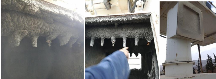
Figure 2. 35 : Absence de nettoyage du malaxeur de la centrale automatique Sogerhwit (photos prises par les auteurs)
