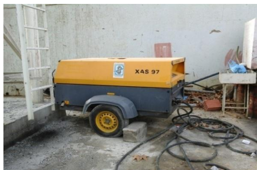
Figure 2. 7 : Le compresseur de la centrale (photo prise par les auteurs)
