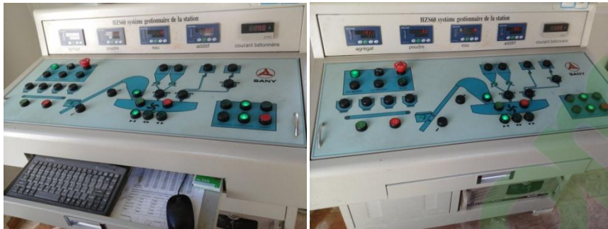
Figure 2.17 : La table de commande (photos prises par les auteurs)
