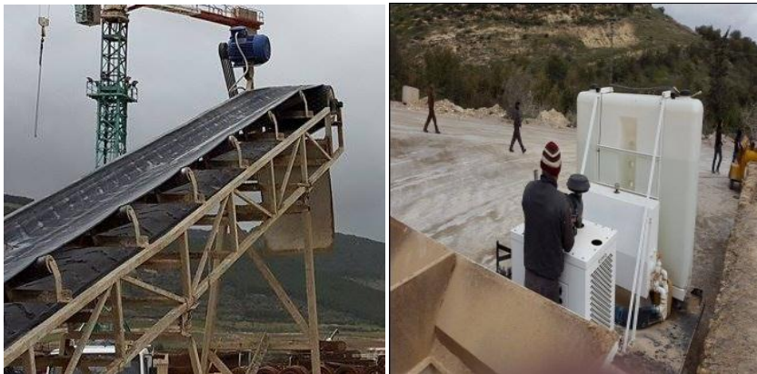
Figure 2. 36 : Le nettoyage du tapis transporteur (la centrale à béton Italienne) (photos prises par les auteurs)
