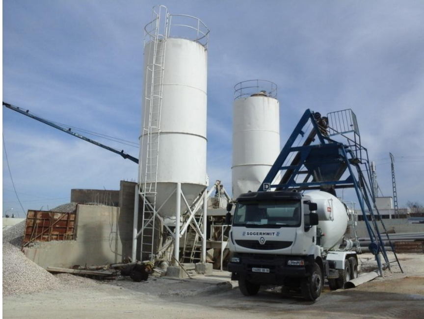
Figure 2. 26 : La centrale manuelle (photo prise par les auteurs)
