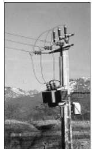
Transformateur aérien (Schneider Electric).
