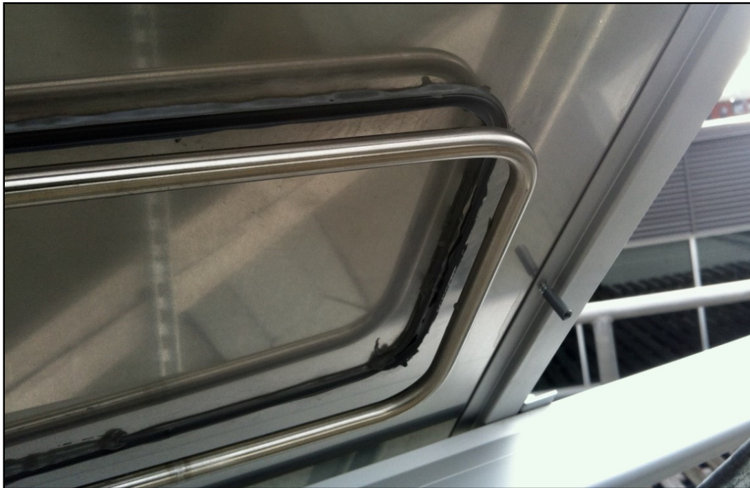
Figure 1.8 Problème de délaminage du serpentín
