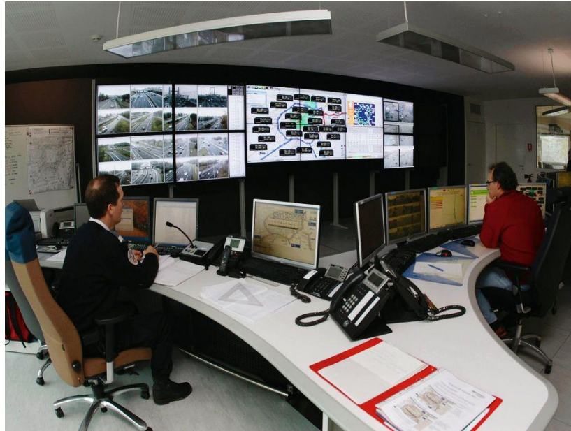
Figure I.6 : Centre de gestion du trafic à Bordeaux
