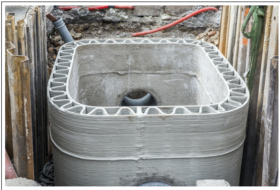
Figure 1.24 Collecteur d'eau de pluie imprimé en 3D Réalisation de l'entreprise (XtreeE, 2017c) http://www.xtreee.eu/projects-stormwater-collector/ Consulté en mars 2019
