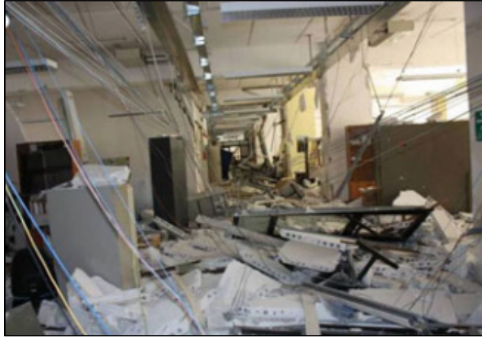
Figure 1.7 Chute des cloisons (séisme L'Aquila en 2011) Tirée de Braga et al. (2011)
