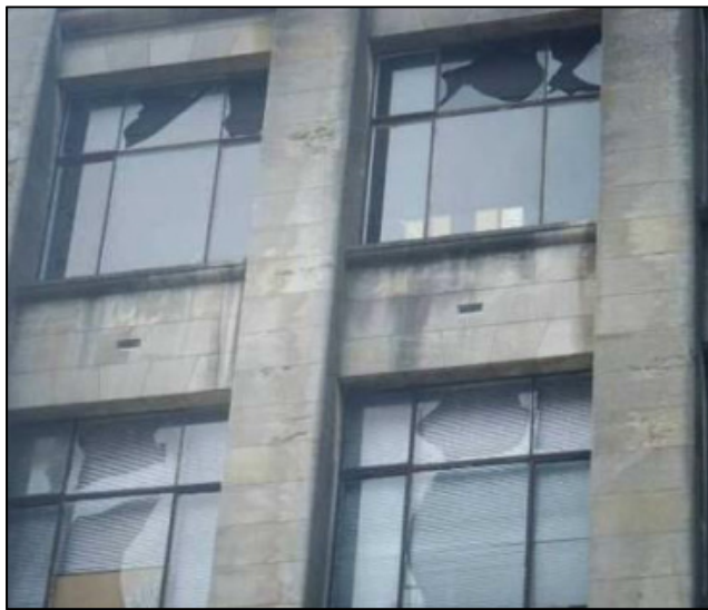
Figure 1.4 Fenêtres brisées (séisme de Canterbury en 2010) http://www.quakecentre.co.nz (consulté en mars 2017)
