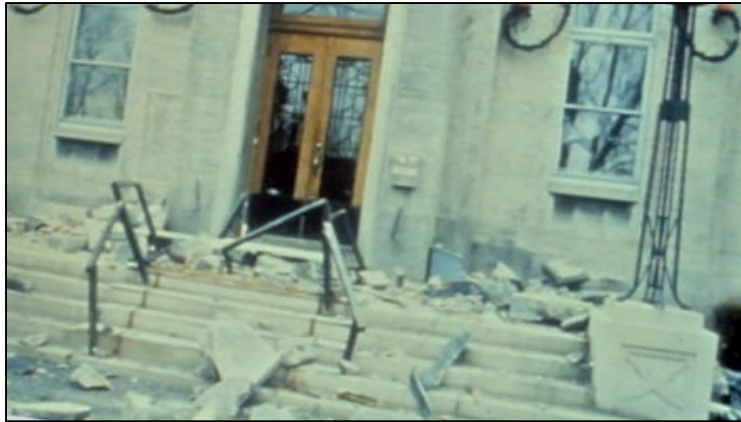
Figure 1.3 Dégâts extérieurs de la façade d'un bâtiment (séisme du Saguenay en 1988) http://www.tvanouvelles.ca (consulté en mars 2017)
