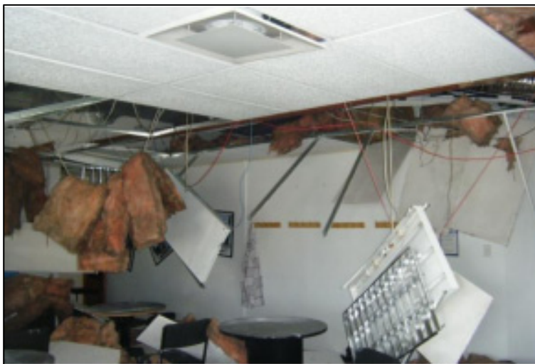
Figure 1.5 Chute des plafonds (séisme de Christchurch en 2011) Tirée de Dhakal et al. (2011)
