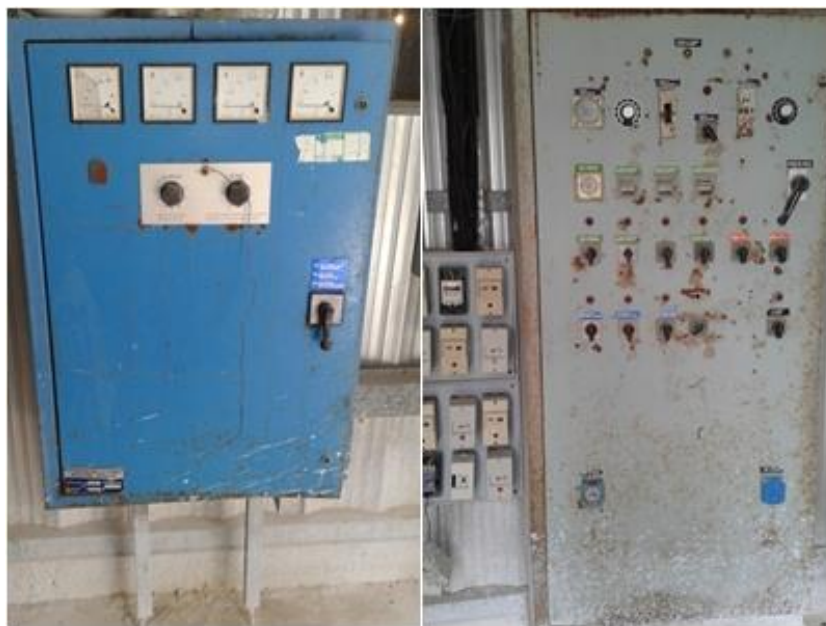
Figure 3.6 Les boîtiers de régulation (Photos source personnelle)
