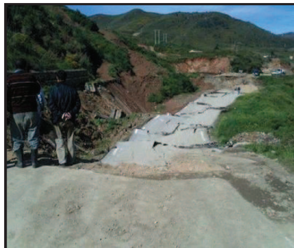
Figure 2.9 Affaissement routier à Béjaïa en 2012
