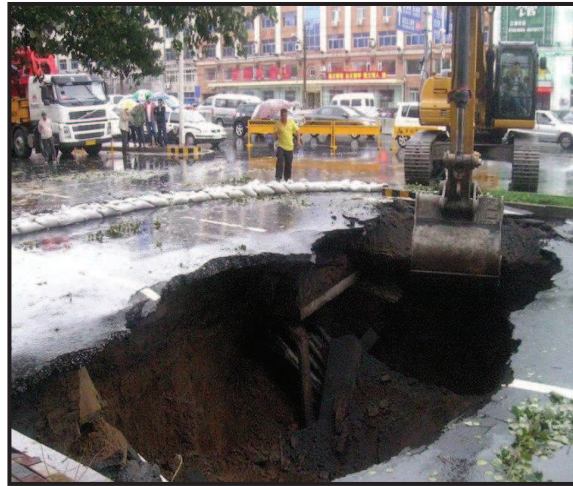
Figure 2.10 Effondrement d'une route à Harbin en 2012
