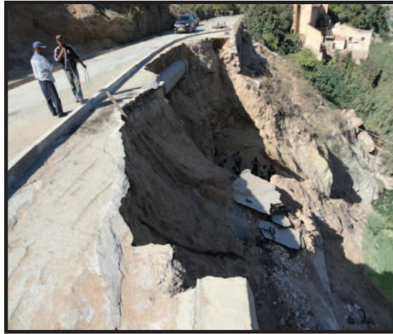
Figure 2.2 Glissement de terrain du chemin communal de Mostaganem (LTPO, 2012)
