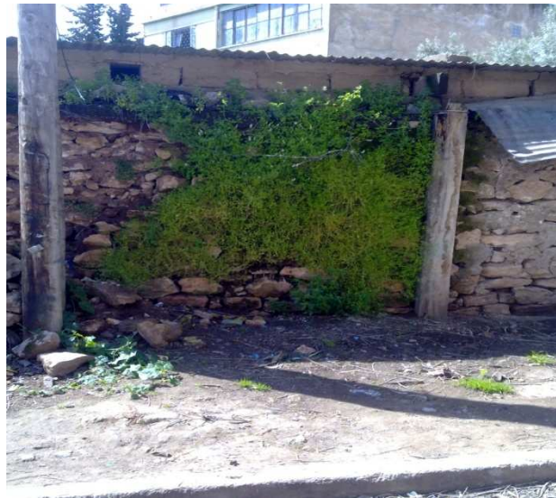
Figure 1.1 7 : Végétation sur un mur
