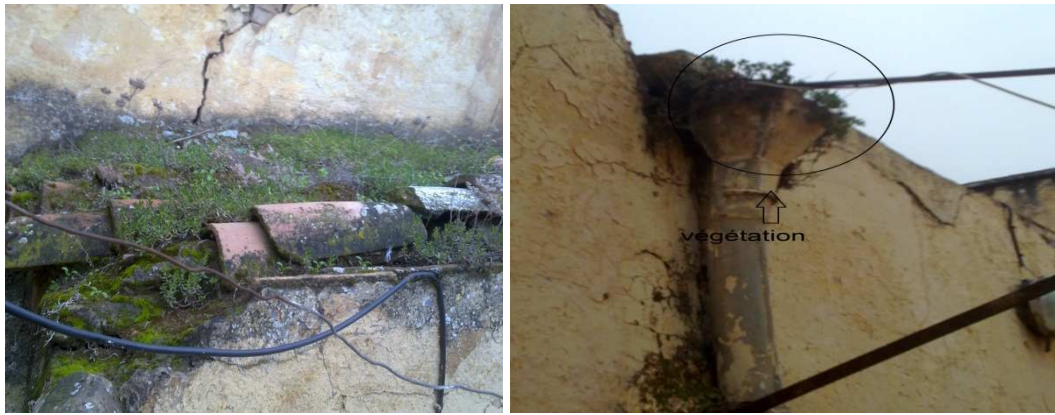
Figure 3.6 : Présence de végétations
