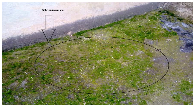
Figure 3.7 : Présence de moisissure
