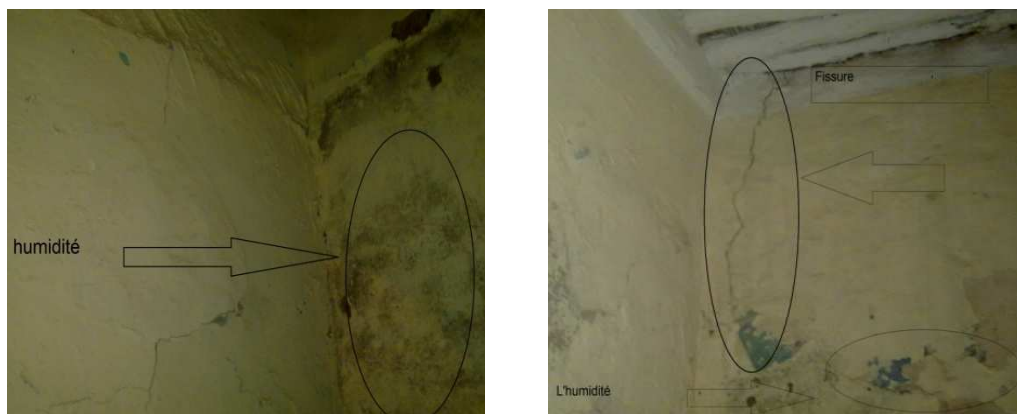
Figure 3.8 : Présence de l'humidité
