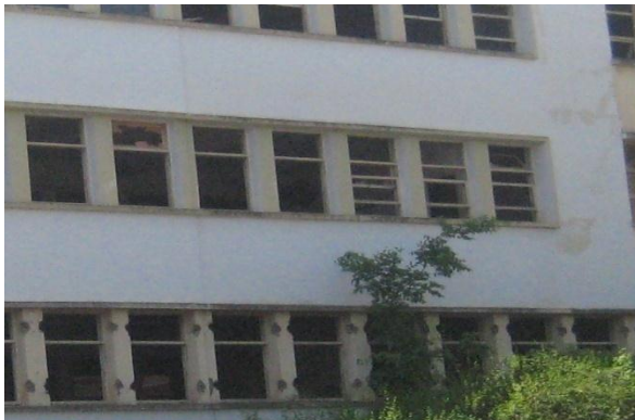
Figure 4.4 : Menuiseries en mauvais état.
