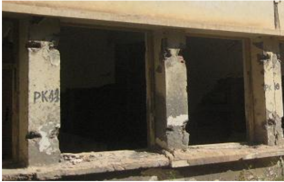
Figure 4.2 : Dégradation des bandeaux et menuiserie en mauvais état.
