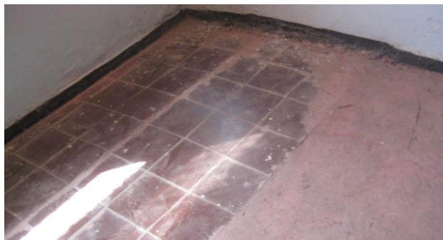
Figure 6.2 : Exemple de carrelage endommagé (partie 3, 1 er étage).
