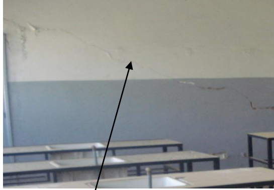
Figure 4.9 : Fissure incliné non passant (L=5m, Ep=1 à 8 mm).
