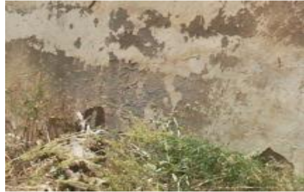
Figure 4.3 : Humidité au pied de mur extérieur due au remonté capillaire.
