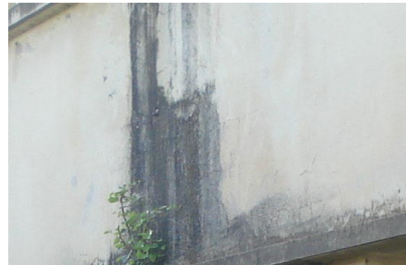
Figure 4.5 : Humidité aux niveaux des tuyaux d'évacuation des eaux pluviales.
