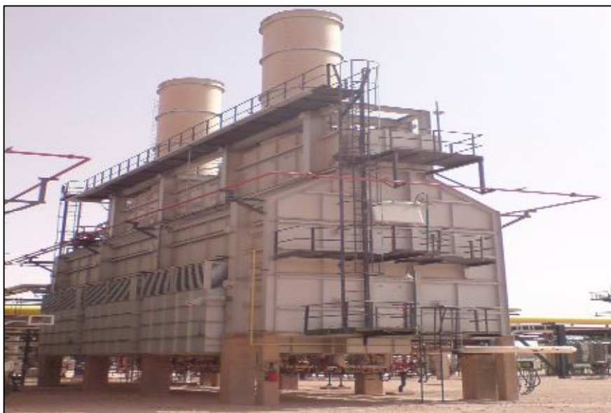
Fig. IV.1- Four Rebouilleur H-101[SONATRACH, 2008]
