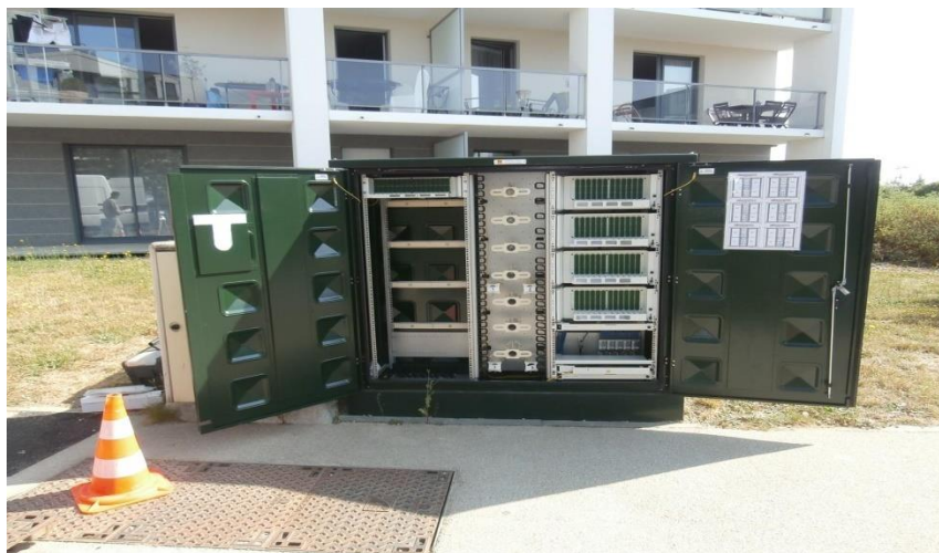
Figure IV.6: Sous Répartiteur Optique SRO.
