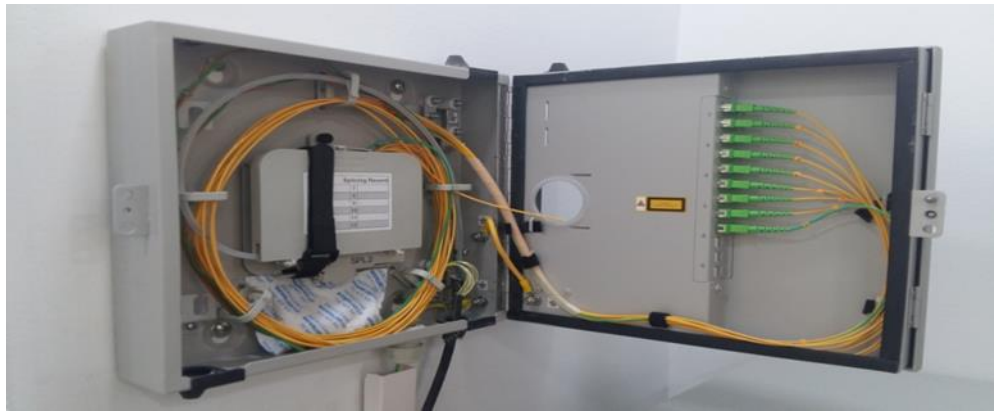
Figure IV.7: Boitier pied de l'immeuble BPI.
