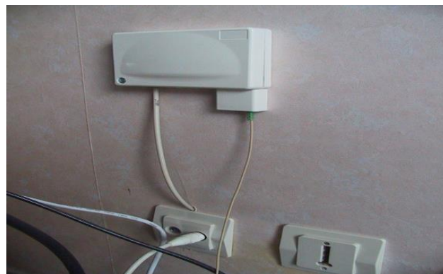
Figure IV.4 : Prise Terminal Optique.
